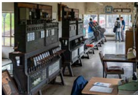
Im Stellwerk W5/6 ist die originale Technik noch vorhanden.. (Foto: Bernd Hahn)
